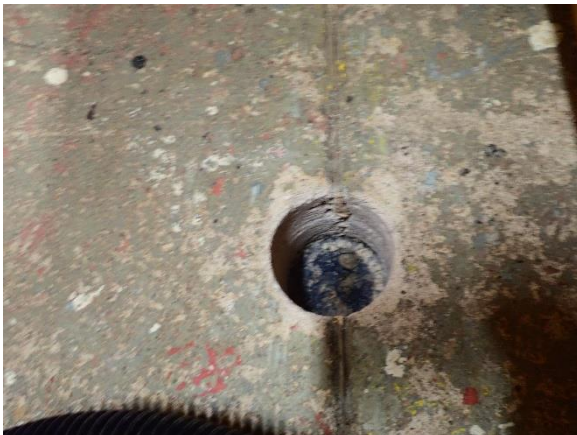
Kuva 6. Alapohjan bitumisively ei sisällä PAH-yhdisteitä yli vaarallisen jätteen raja-arvon.
