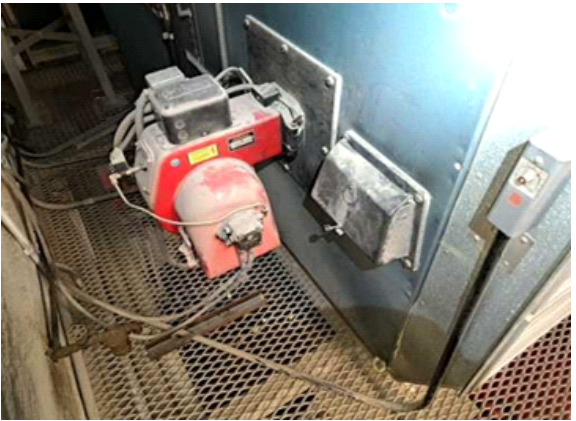
Kuva 4. Lämminilmakehittimen luukkujen tiivistyksissä asbestia.
