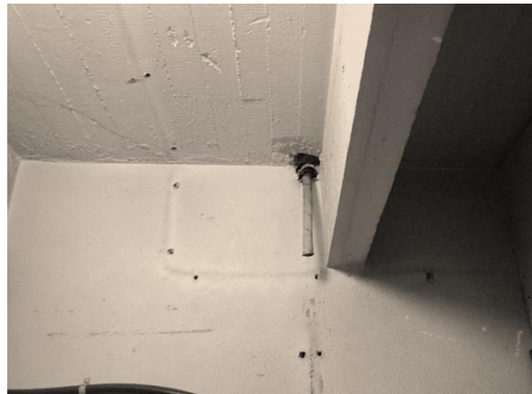
Kuva 7. Kohteessa havaittiin vanhoja sähköjohtojen eristeitä, jotka sisältävät PAH-yhdisteitä.
