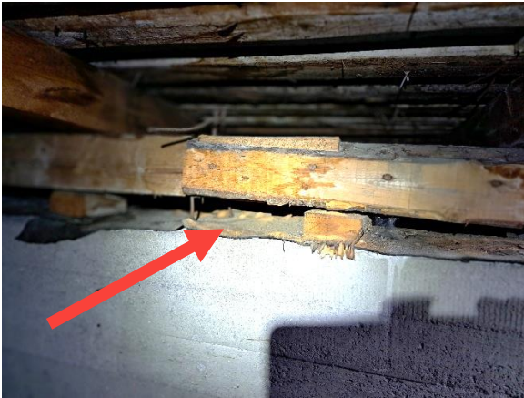
Kuva 2. Kuvassa näkyvä yläpohjan bitumikermi sisältää asbestia.
