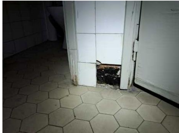
Kuva 3. Kosteiden tilojen bitumisively sisältää asbestia.
