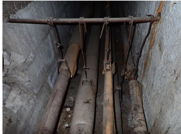
Kuva 5. Vanhat putkieristeet sisältävät asbestia.
