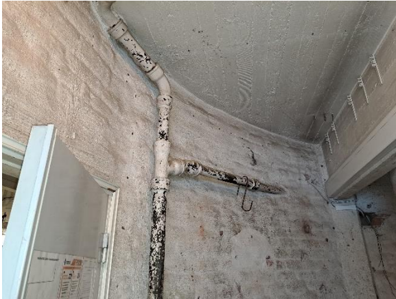
Kuva 8. Vanha valurautaviemäri ensimmäisessä kerroksessa. Tiivisteissä on lyijyä.
